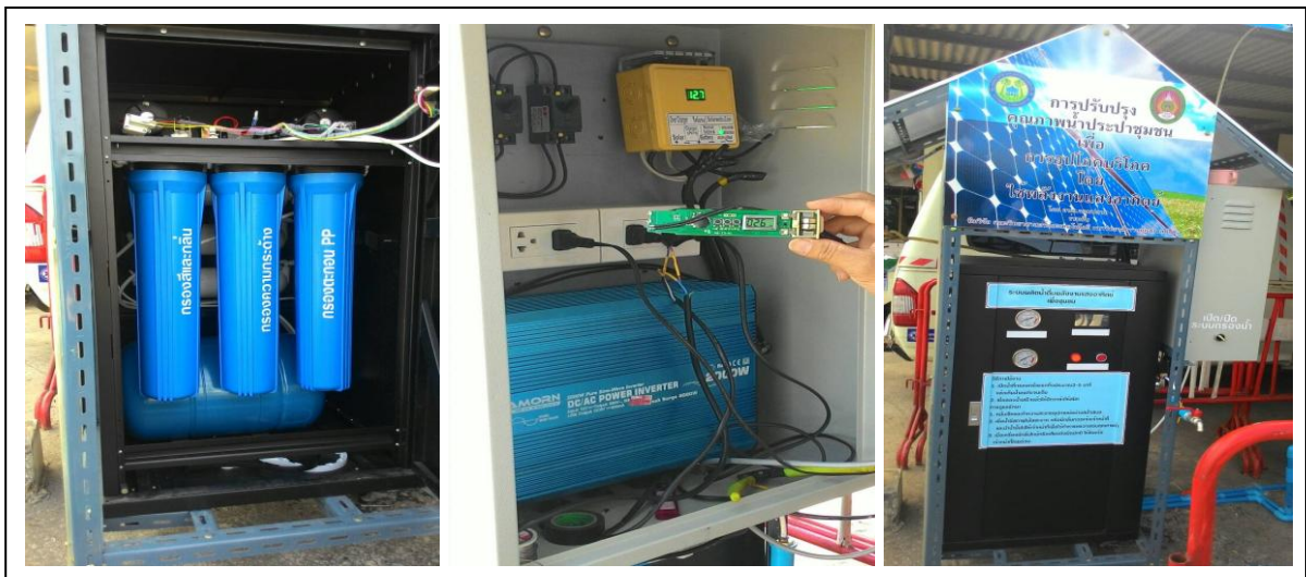
ภาพที่ 4.2 ระบบกรองน้ำโดยใช้พลังงานแสงอาทิตย์ร่วม
